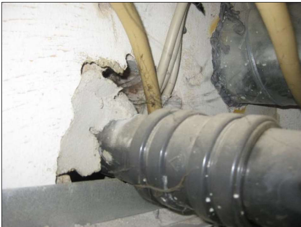
Afløb ført ind i oprindelig skorsten er ikke tætnet - stueetage i administration. Væggen er sandsynligvis brandsektionsvæg
