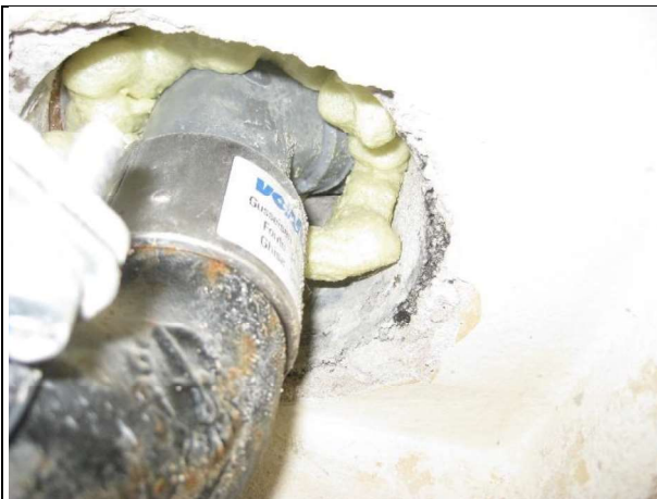
Gennemføringer i nr. 10.0.3 til overliggende baderum er ikke tætnet.
