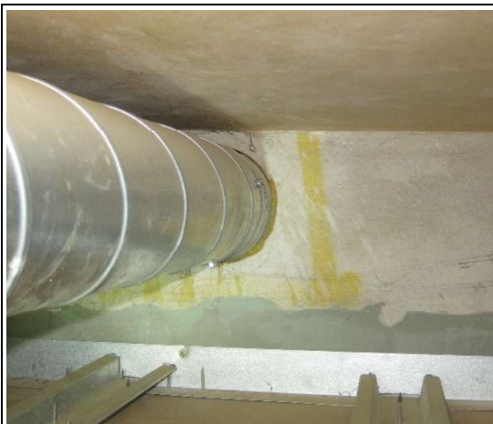
Ventilation ført ind i oprindelig skorsten er tætnet med fugemasse – lejl. Nr. 4.0.3. Væggen er sandsynligvis brandsektionsvæg
