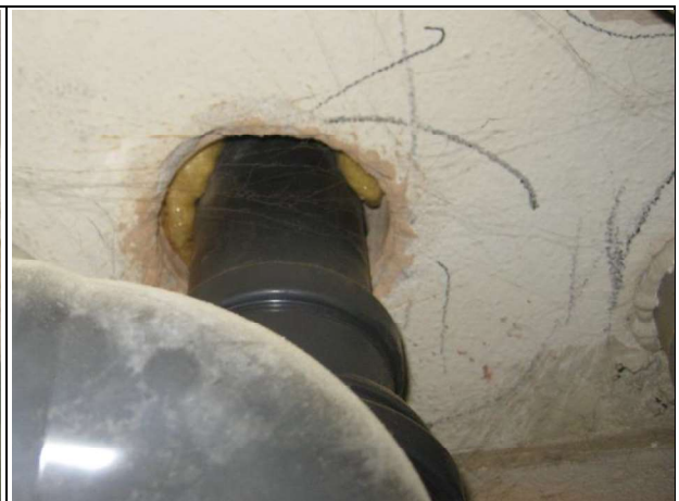
Gennemføring i nr. 4.1.1 til overliggende lejlighed er ikke tætnet
