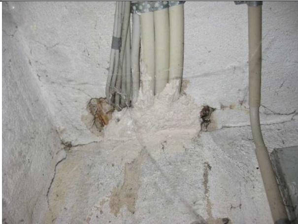
Opføring af kabler fra kælder til stueetage er forsøgt tætnet – tvivlsom kvalitet
