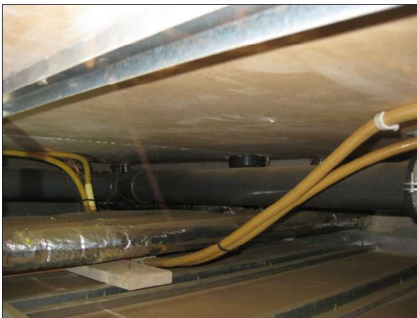
Gipsloft i nr. 4.st.3, hvor der burde være pladsstøbt beton
